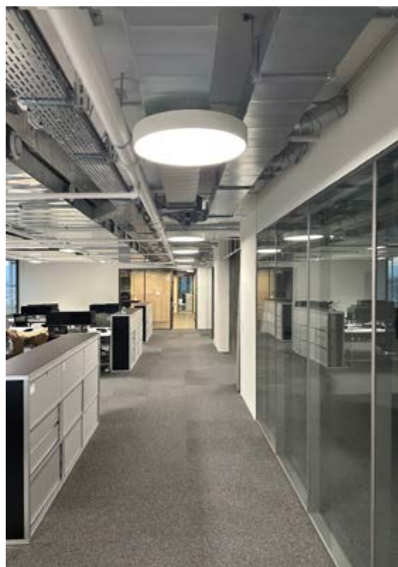
Trivalite Leuchten: weniger Energieverbrauch durch Kombination von Steuerung und Beleuchtung.
