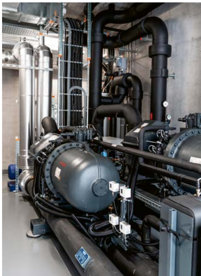
Die Fernwärmeleitungen in der Zentrale der IBC Chur. (Bild: IBC Chur)
