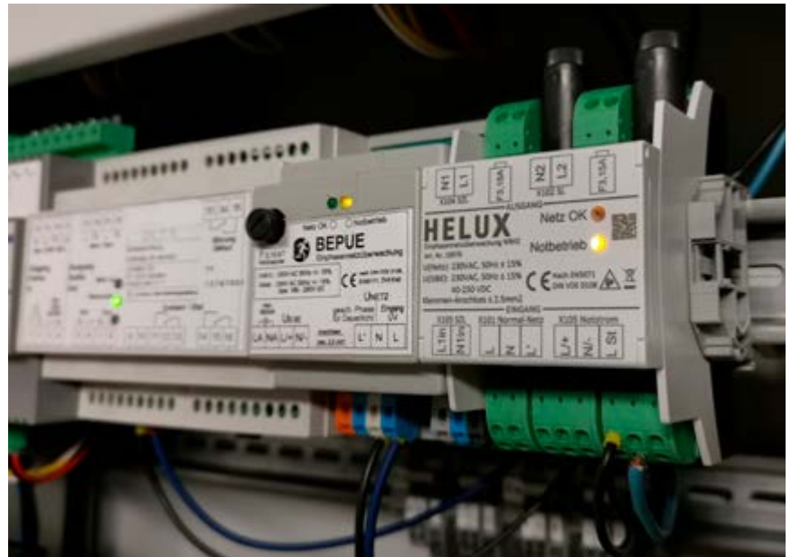
Neues NRH2 Relais für AC- und DC Test (rechts) neben zwei Fremd-Relais mit weniger Funktionen.
