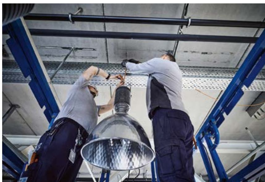
Nouvelle solution d'éclairage durable conçue avec les luminaires existants.
