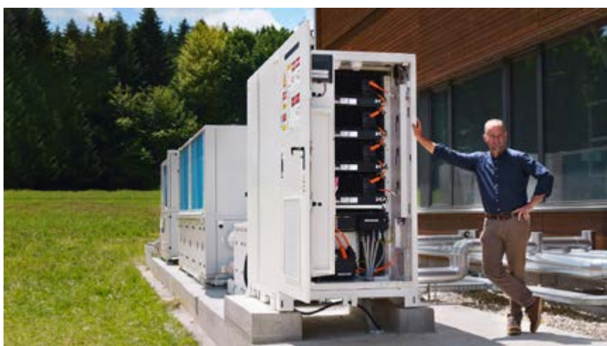
Hans-Ulrich Held devant l'entrepôt industriel de Biofarm – pour une consommation propre accrue et des coûts énergétiques réduits.
