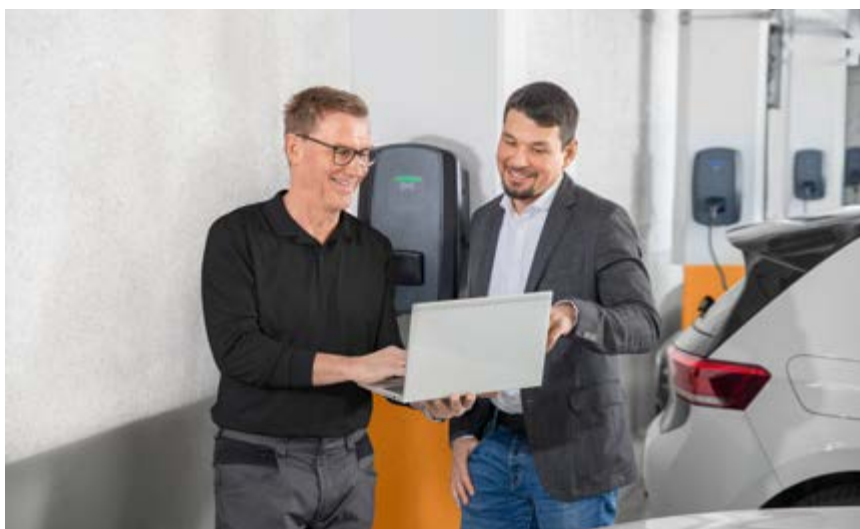
Il est possible de commander et de surveiller jusqu'à 50 bornes de recharge AC SMART sur l'interface Web.
