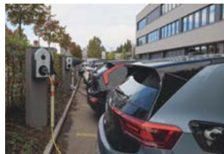
Le système de gestion de la charge contrôle plus de 30 stations de recharge AC et DC de différents fabricants.
