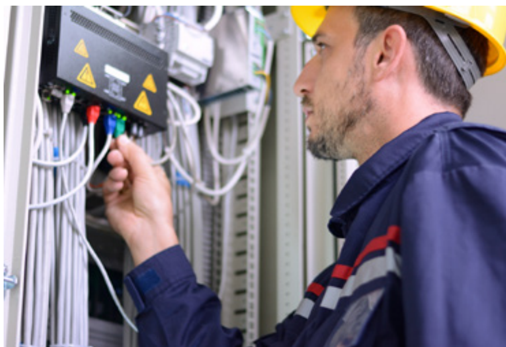
Se un tempo bastava un cavo elettrico, oggi nel quadro elettrico convergono numerosi cavi dati e il cablaggio ordinato sta diventando una disciplina a sé stante.
