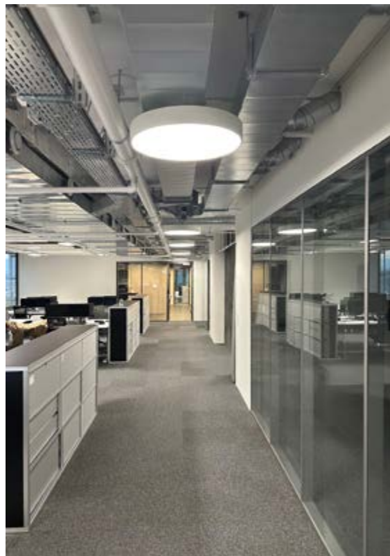
Lampade Trivalite: minor consumo energetico grazie alla combinazione di controllo e illuminazione.
