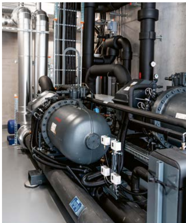
Les conduites de chauffage à distance dans la centrale d'IBC Chur. (Photo: IBC Chur)
